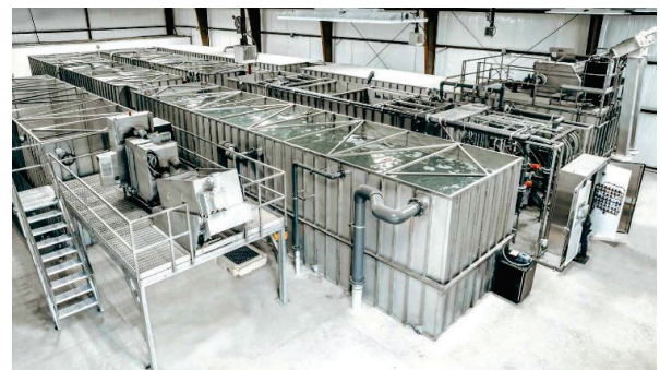
Cloacina MEMPAC-M installation
